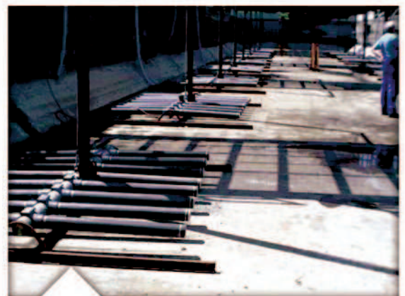
Grile de aerare cu difuzori tub retractabile cu ghidaj, care au fuctionat peste 10 ani in statie de epurare municipala.
