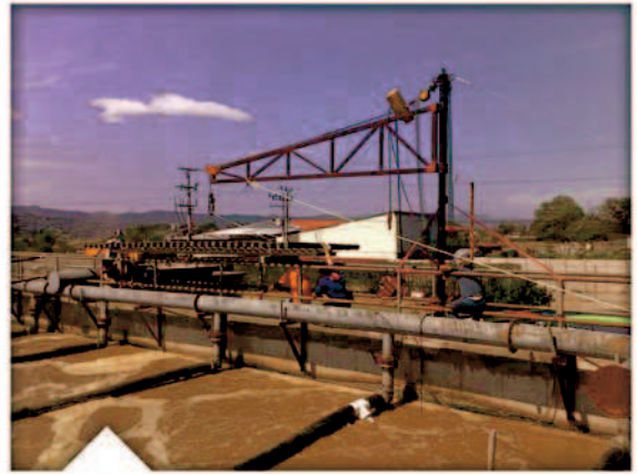
Sistem de aerare retractabil cu difuzori si conexiune rapida si cadru din SS304, inlocuind un sistem de aerare neperformant.
