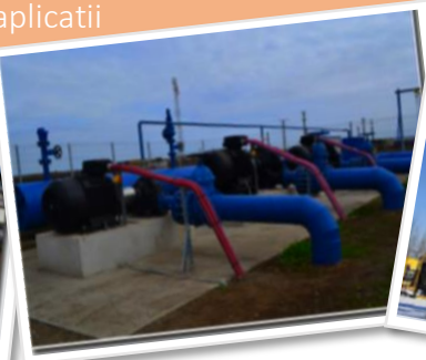
Statii de pompare
