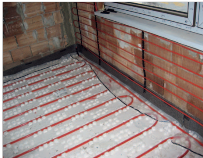
Încălzire pardoseală și pereți sistem umed
