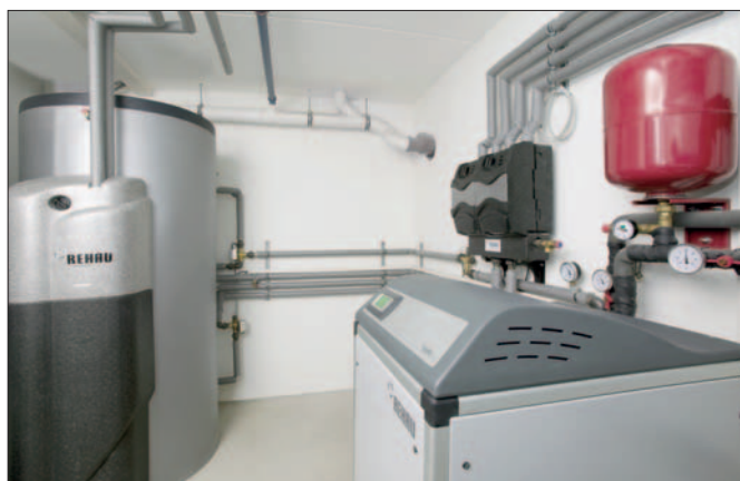
Centrală termică complet echipată cu pompa de căldură de la REHAU
