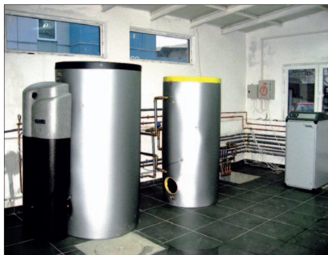
Pompă de caldură - laborator Facultatea de Instalații din București
