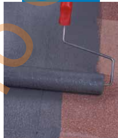
Aplicarea de Eco Prim Grip pe o pardoseală din dale terazzo, cu trafalet
