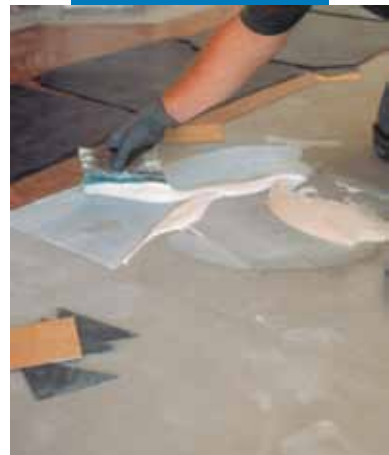
Exemplu de instalare a covorului PVC pe o suprafață nivelată cu șapa autonivelantă Ultraplan - CD2 - Milano - Italia
