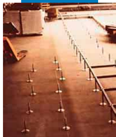
Substrat nivelat cu șapa autonivelantă Ultraplan gata pentru instalarea unei pardoseli tehnice
