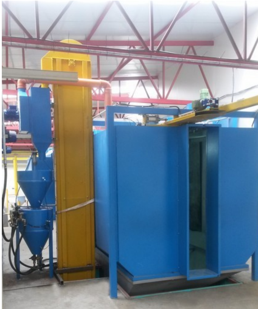
1. Cabina de sablare și instalația de recuperare și realimentare
