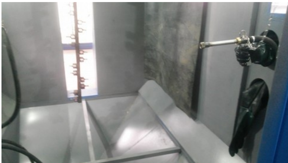
3. Interiorul cabinei: perdea de cauciuc, pistol de sablare, mănuși de protecție amplasați pe mai multe nivele, în partea inferioară: pâlnie îngropată de recuperare
