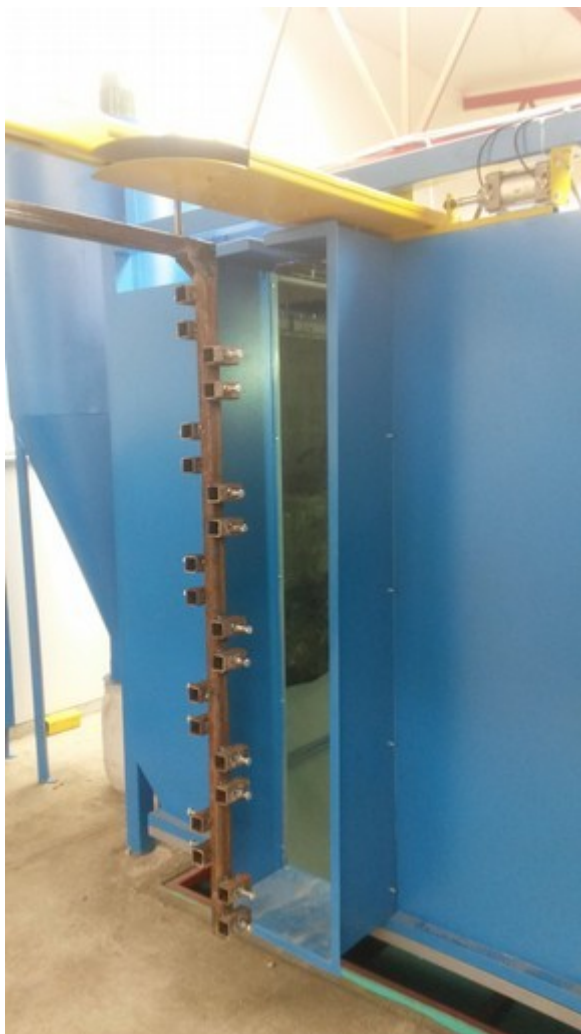
7. ieșire din cabină, în partea superioară conveiorul automat cu deplasare cu viteză variabilă și dispozitivul pneumatic de decuplare conveior
