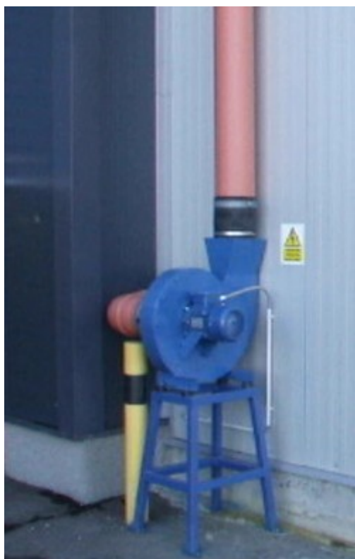
9. Ventilator de exhaustare aburi
