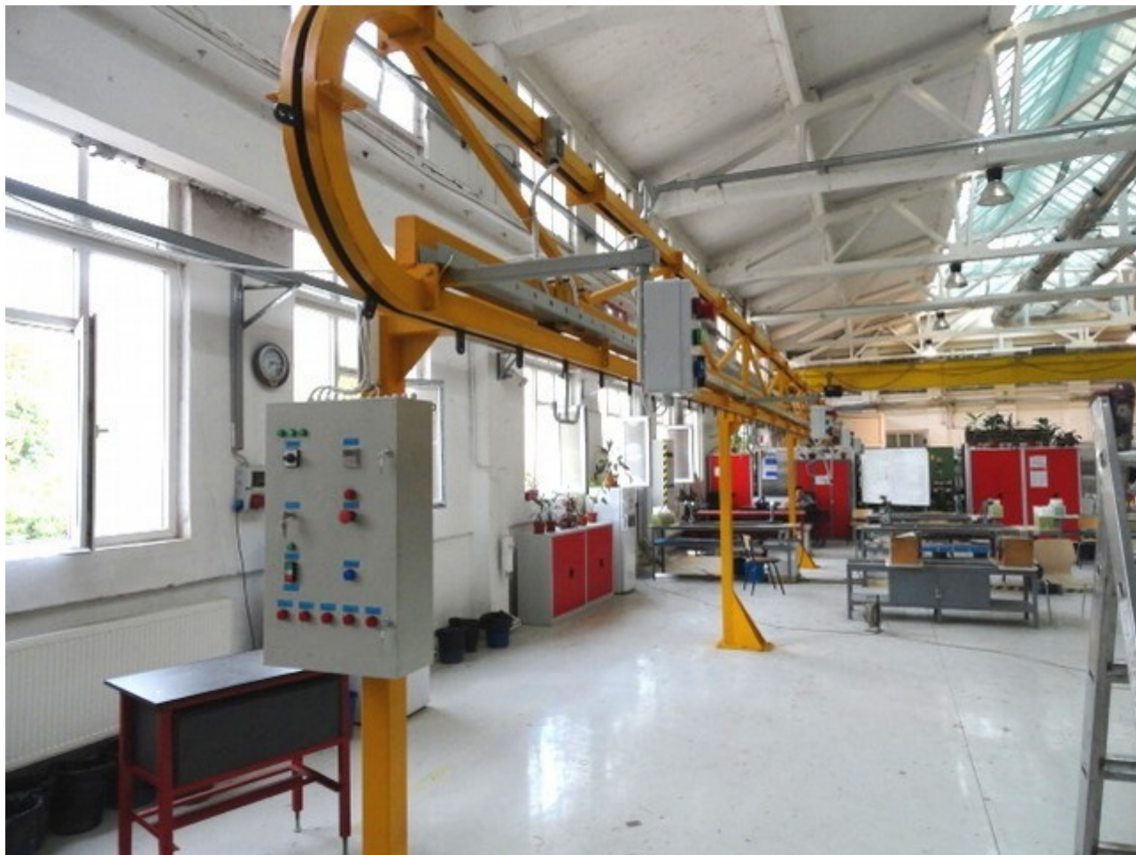
1. Linie de conveiere verticală cu deplasări în tact și tabloul principal de comandă
