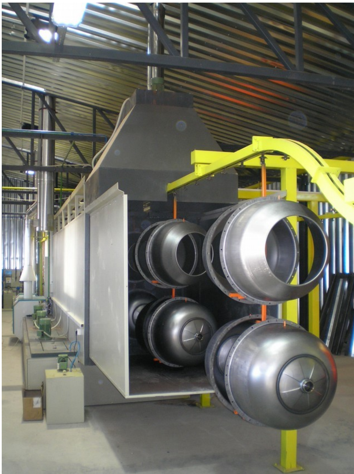
3. Intrare în cabina de degresare-fosfatare
