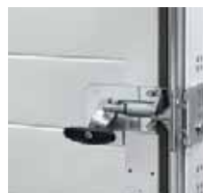
Ușile de garaj acționate manual și prevăzute cu ușa pietonală înglobată nu dispun de mâner la exterior. Ele se închid pe dinăuntru.
